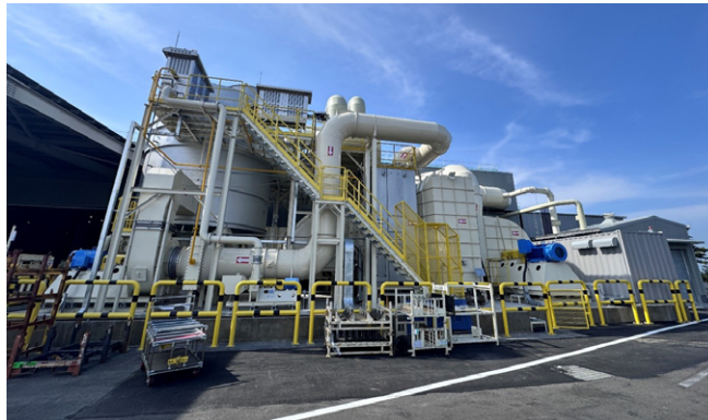
스마트팩토리 고용량 RTO(Regenerative Thermal Oxidizer) 설비
